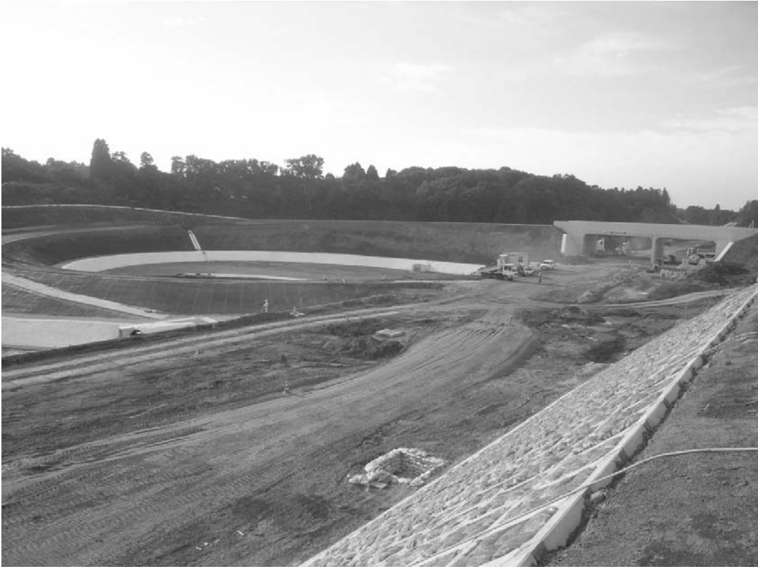
平成20年度開通に向けて改良工事中の稲敷 | C。料金所出入口付近から | C内を望む。
